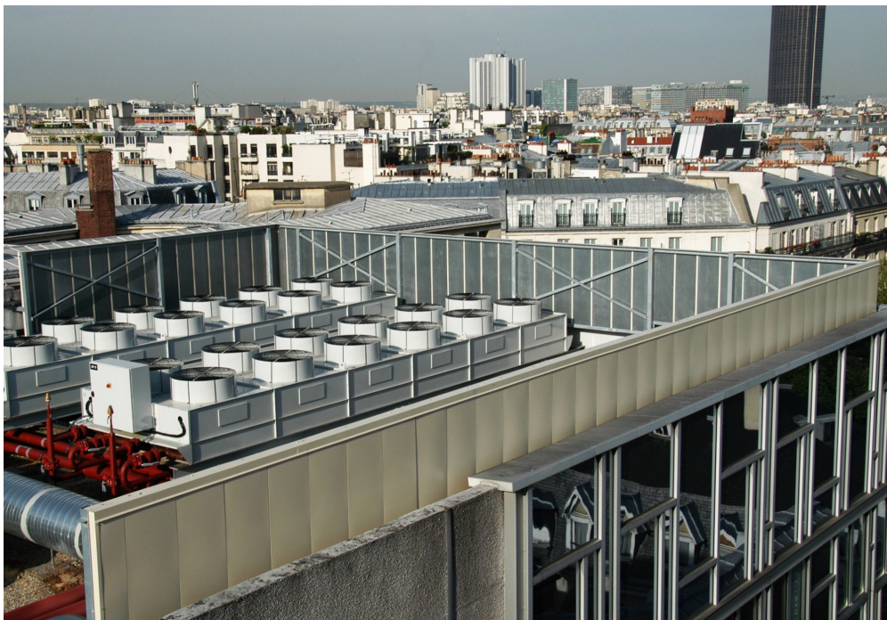
- Ecran acoustique Bruit d'équipements Climatisation Institut Curie -
