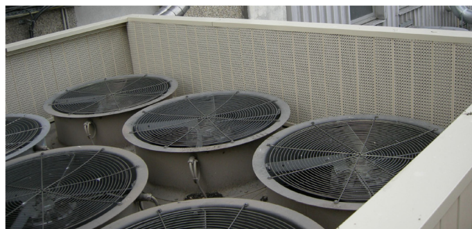
- Cheminée Acoustique sur Groupe froid -
