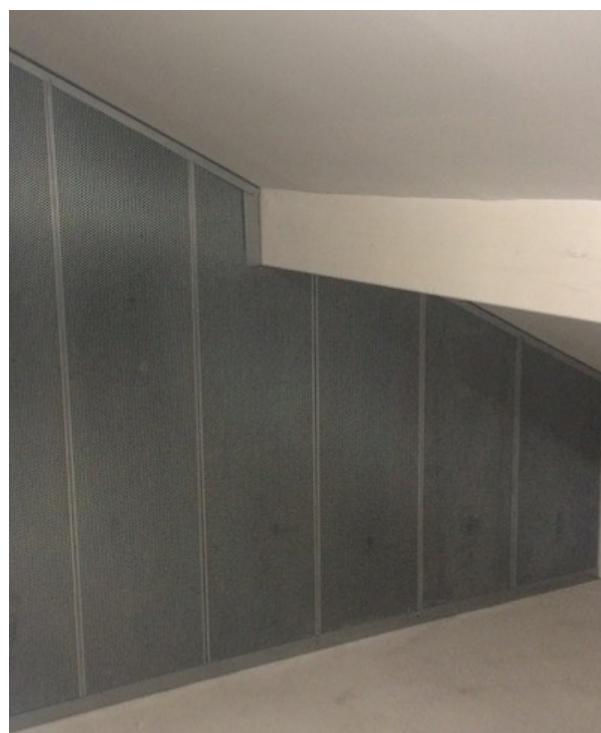
- Traitement acoustique mural par panneaux PALT50 -
