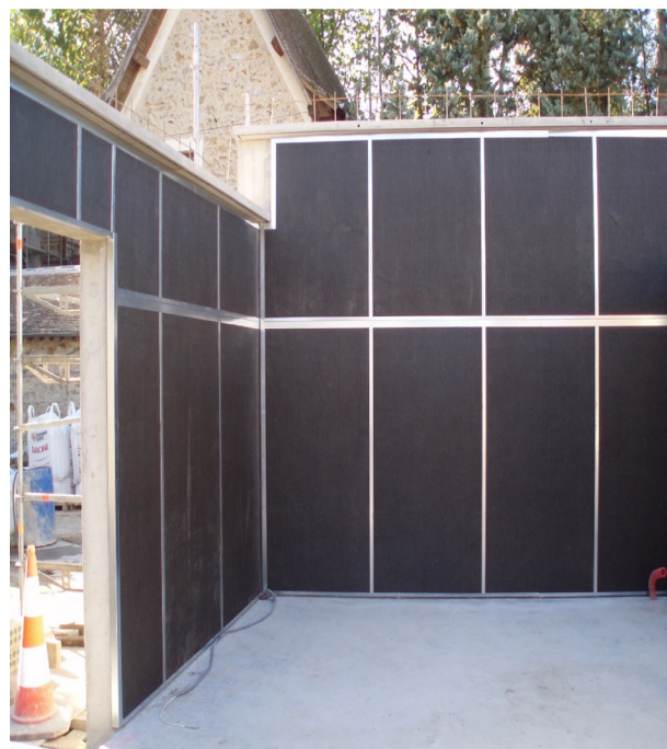
- Traitement acoustique mural par panneaux HDTV50 -
